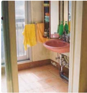
☞ 세면대를 베란다에 설치한 예
